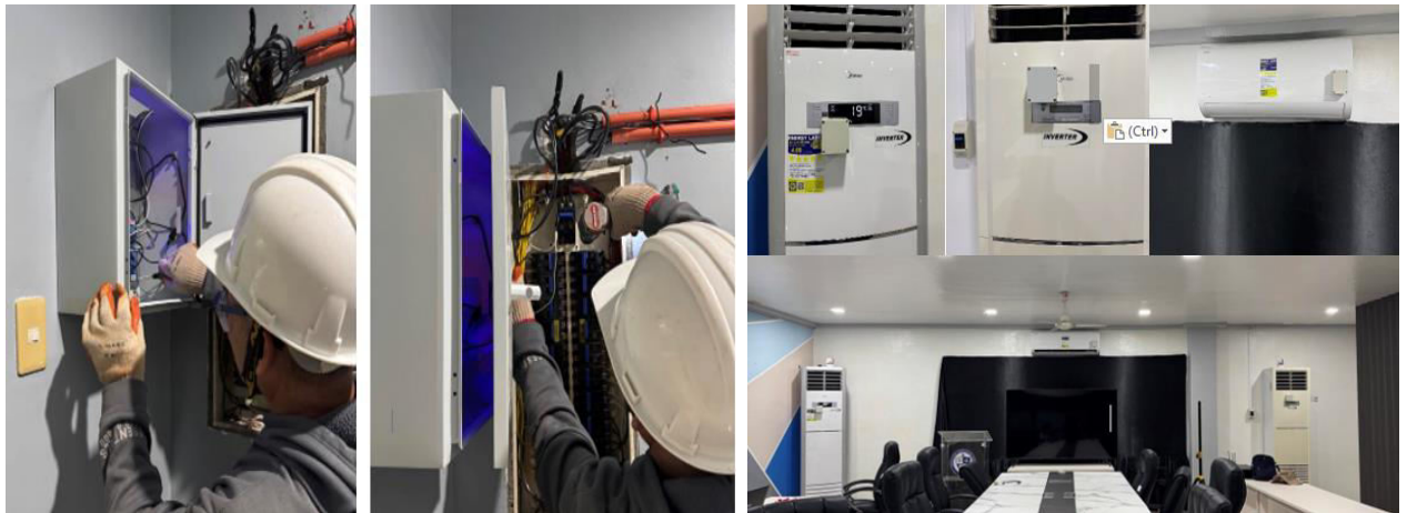
Fig 12. HVAC IoT enabled Setup
